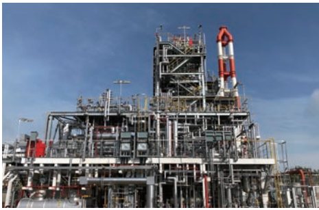
環境に配慮したエタノール由来のエチレン試験製造設備
