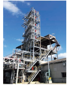
ケミカルリサイクル実証設備 (愛媛工場)
