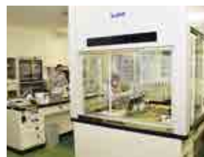
局所排気装置(ドラフト)
