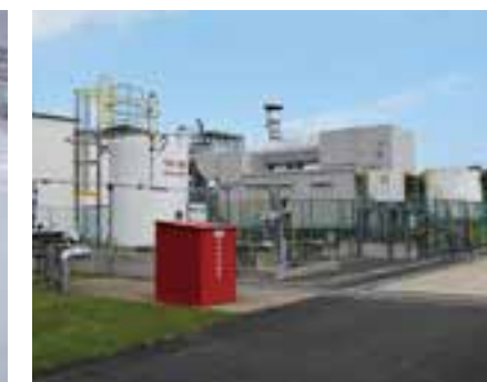
非常用発電機
