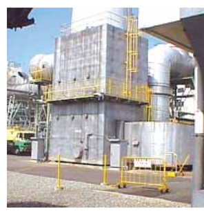
排煙脱硝設備
