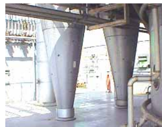
粉じん捕集設備
