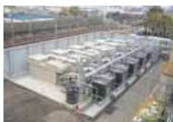
ガスエンジン
