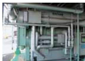
※3 蒸気吸収式冷凍機
