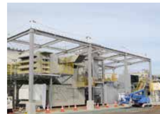
新CGS(設置工事中)
