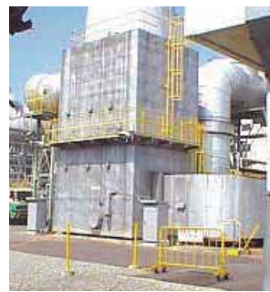
排煙脱硝設備
