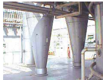
粉じん捕集設備
