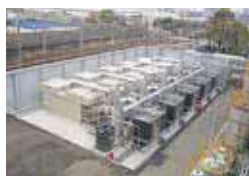
ガスエンジン
