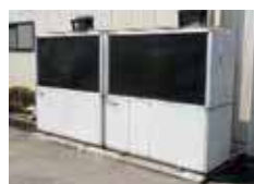
※4 ガスヒートポンプ
