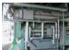
※3 蒸気吸収式冷凍機
