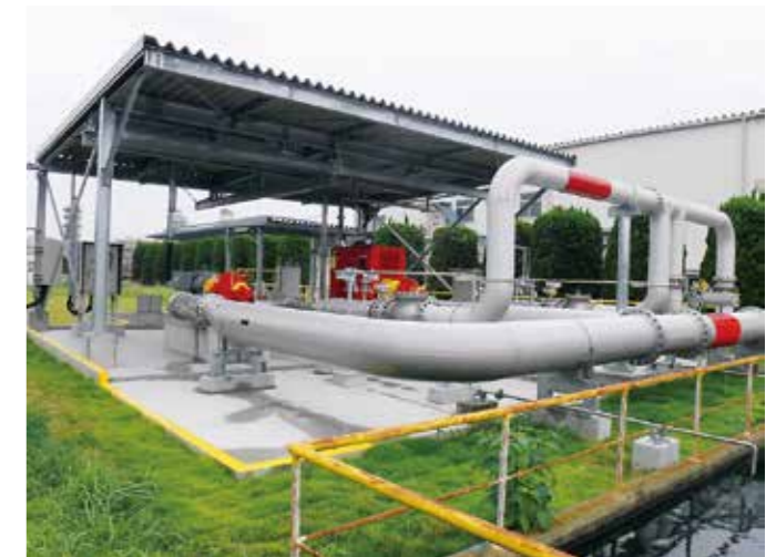
消火用水設備増強
