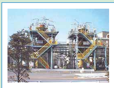
高濃度廃水焼却設備
