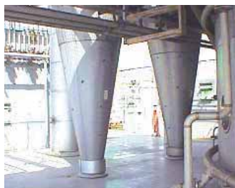
粉じん捕集設備
