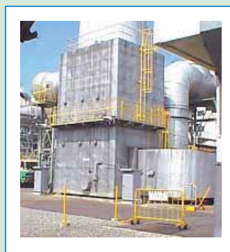
排煙脱硝設備
