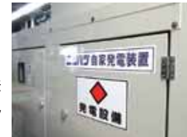
緊急用自家発電装置
