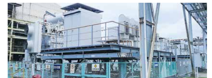
電気設備かさ上げ
