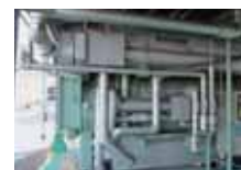
※2 蒸気吸収式冷凍機
