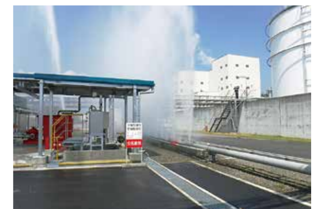
消防ポンプ保護用ウォーターカーテン
