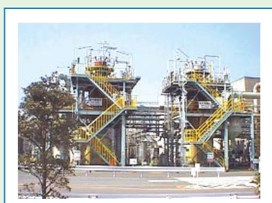
高濃度廃水焼却設備
