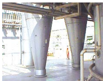
粉じん捕集設備
