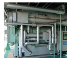
※2 蒸気吸収式冷凍機
