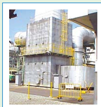
排煙脱硝設備
