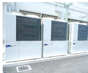
※3 ガスヒートポンプ
