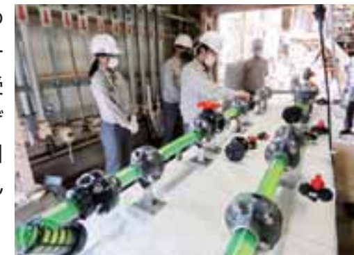
残液体験…普段見えない配管内の残液を体験します
