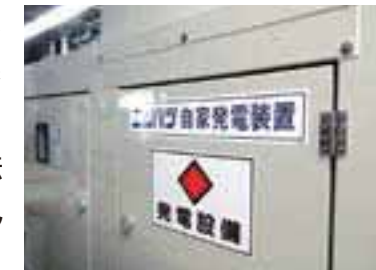
緊急用自家発電装置
