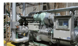
フロン冷凍機
