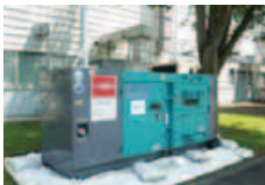
筑波研究所のレンタル自家発電設備。
