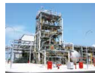
シンガポールのS-SBRの新プラント
