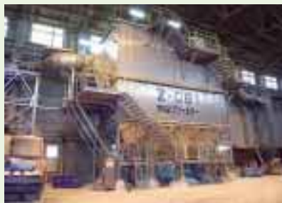
化成肥料工場乾燥機リン回収設備(バグフィルタ)
