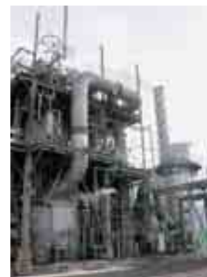
排水燃焼設備（愛媛工場）
