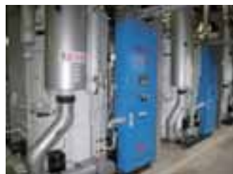
更新後のボイラー。
