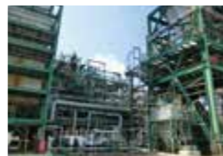
袖ヶ浦II地区ボイラー
