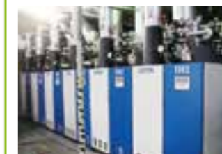
小型貫流ボイラー
