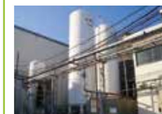
LNGサテライト設備
