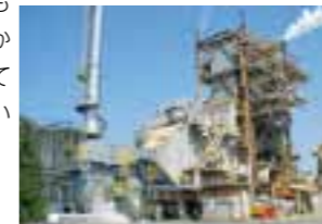
ソーダ回収ボイラー 新設備
