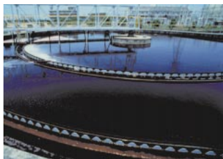
排水処理設備
