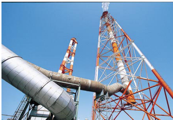
独自技術による排煙脱硝設備
