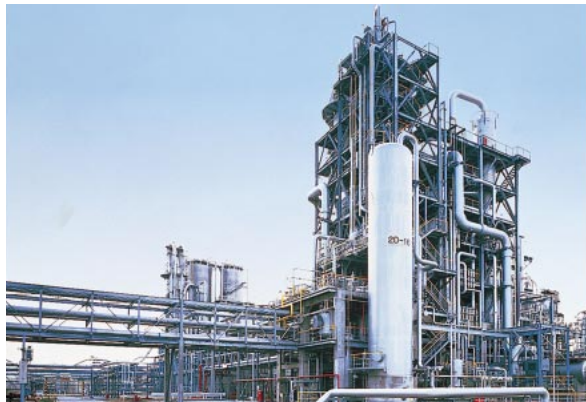
気相法ポリプロピレン製造設備
