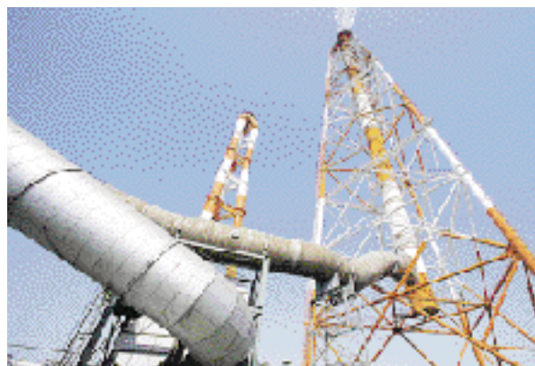
独自技術による排煙脱硝設備
