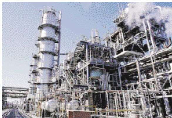
自社開発技術によるレゾルシン製造設備
