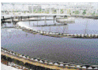
排水処理設備
