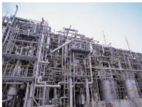
カプロラクタムのパイロット設備
