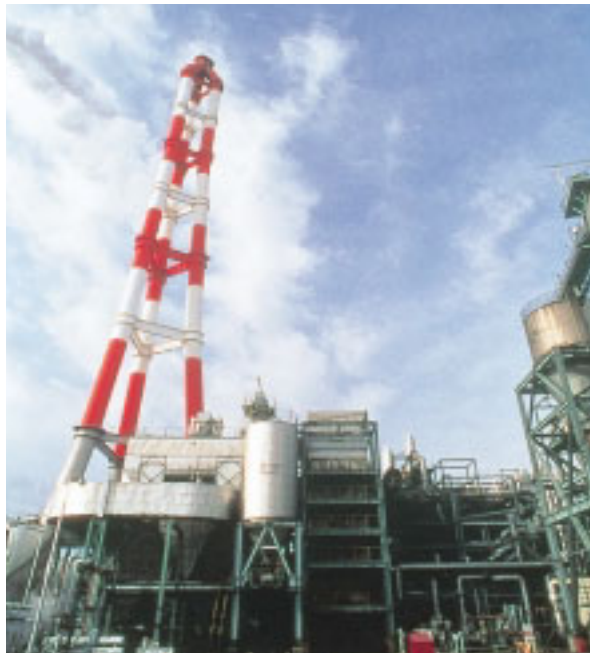
独自技術による排煙脱硝設備
