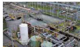
活性汚泥処理施設
