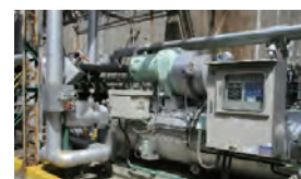
フロン冷凍機
