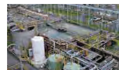
活性汚泥処理施設
