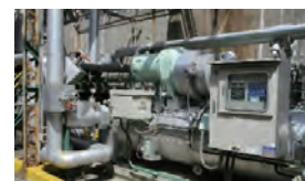
フロン冷凍機
