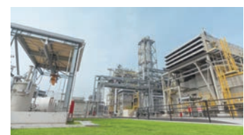
新居浜北火力発電所
