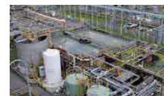
活性汚泥処理施設
