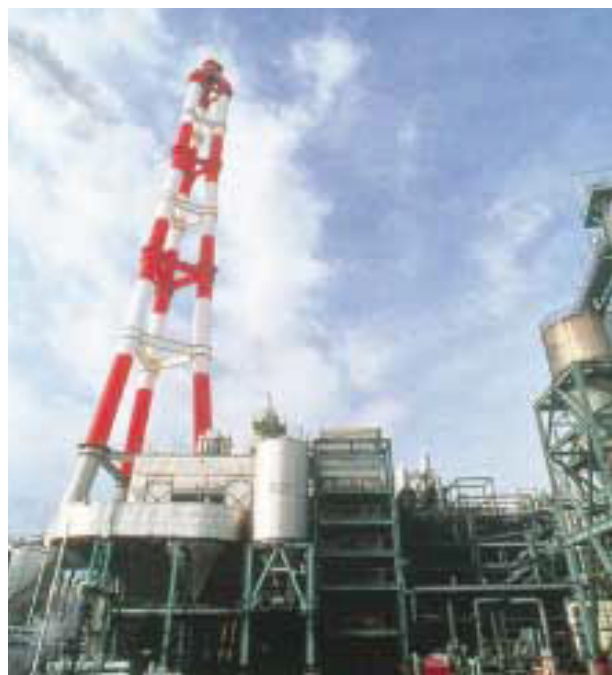
独自技術による排煙脱硝設備
