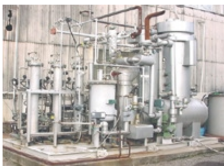
Fig. 11 20MH H 2 Generator
