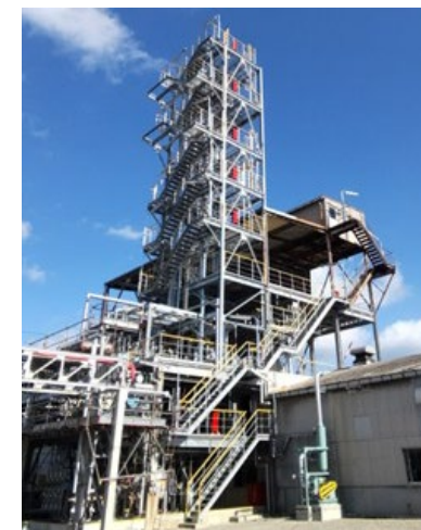
PMMAケミカルリサイクル実証設備
