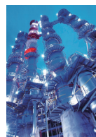
プロピレン オキサイド 製造プラント （千葉工場）
