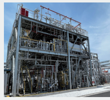
エタノールからプロピレンを直接製造するパイロット設備※1
