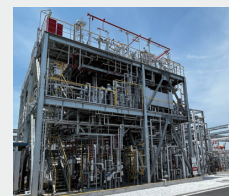
エタノールからプロピレンを直接製造するパイロット設備※1
