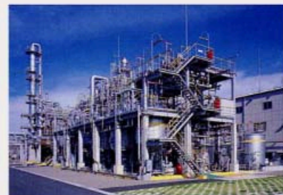
ゴム用老化防止剤「アンチゲン6C」製造設備
