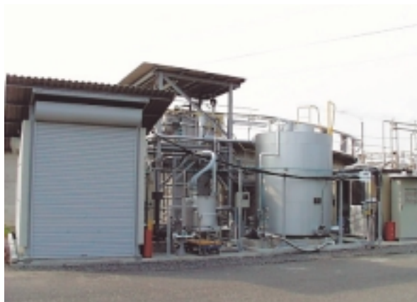
第10図 微生物培養パイロットプラント
