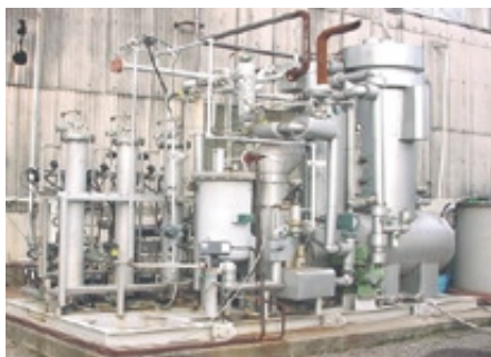
Fig. 11 20MH H 2 Generator
