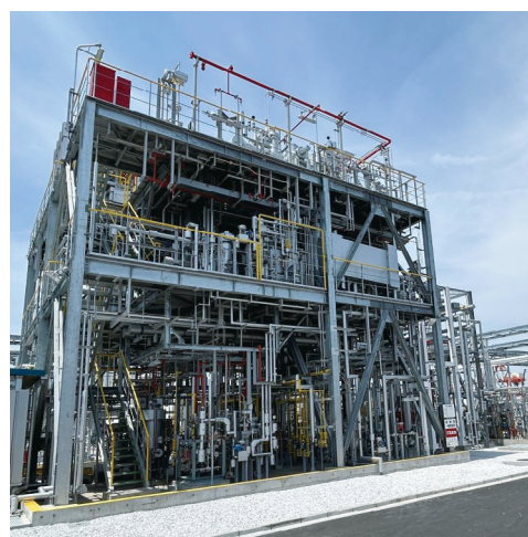
パイロットプラント外観
