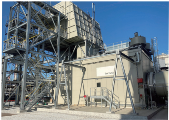
千葉工場の高効率ガスタービン発電設備
