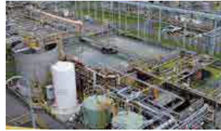
活性汚泥処理施設
