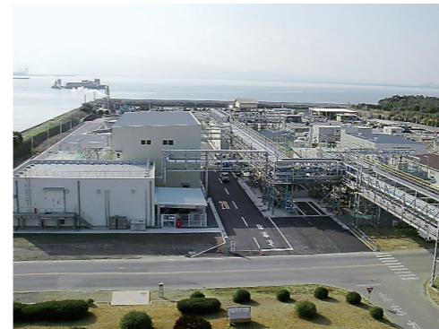
排水処理設備
