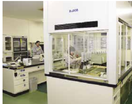
局所排気装置(ドラフト)
