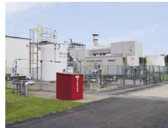
非常用発電機
