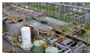
活性汚泥処理施設
