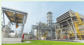
新居浜北火力発電所
