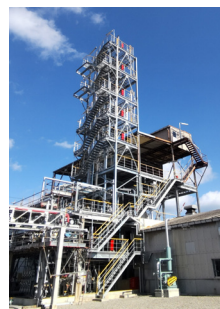
PMMAケミカルリサイクル 実証設備
