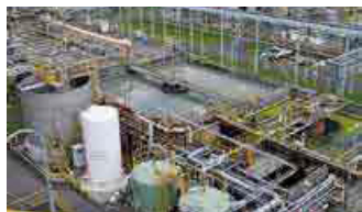
活性汚泥処理施設
