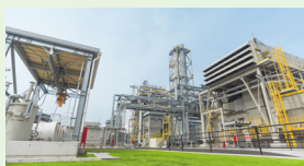
新居浜北火力発電所
