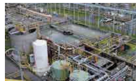
活性汚泥処理施設
